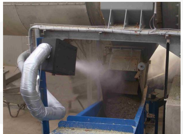
Staubbindungsanlage mit Frostschutz
